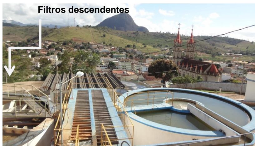
Figura 3-40 - Estação de Tratamento de Água de Itaguaçu.
